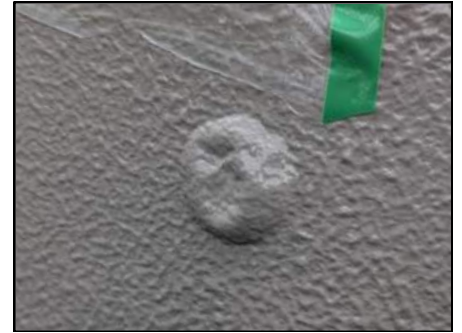
外壁塗装の防水層の膨れ
